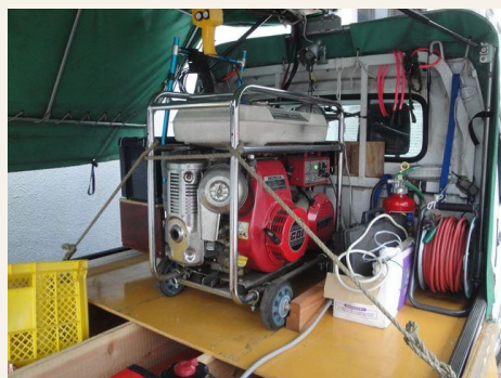
軽トラックに乗せた発電機
